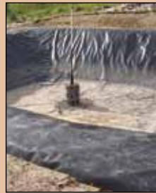
Rellenos sanitarios con geo-membrana
